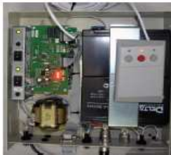
Ausgangszustand in der Steuerung und mit Fernbedienung (WMD)
